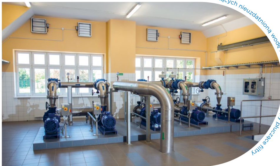
Wnętrze stacji uzdatniania wody ujęcia Zaspą Wodną
