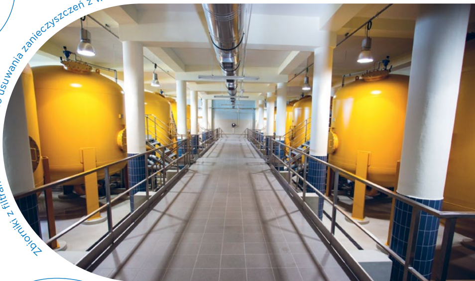
Wnętrze stacji uzdatniania wody ujęcia Osowa
