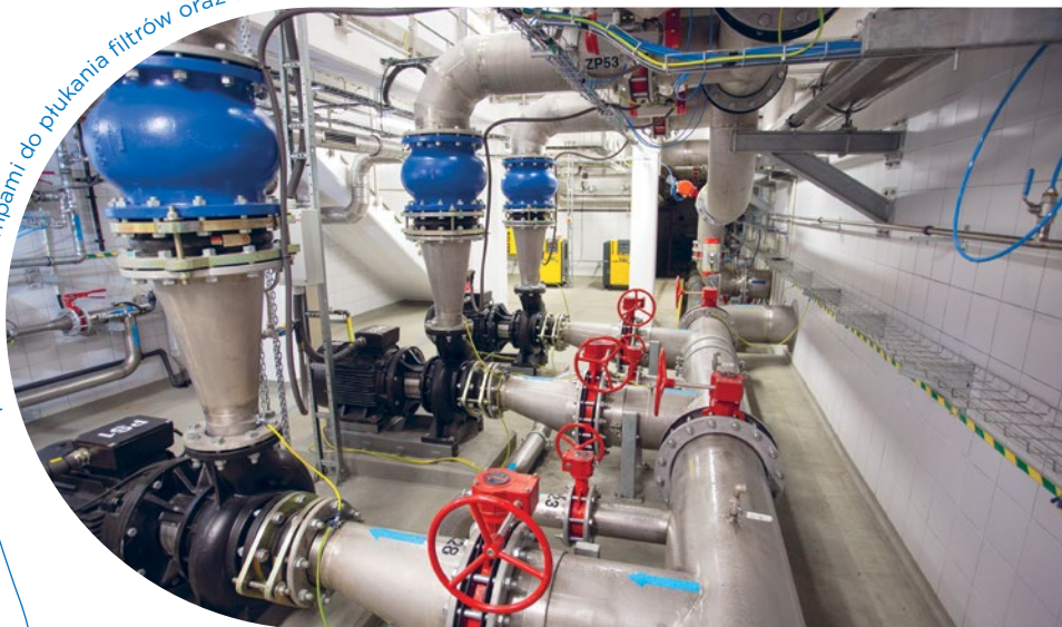
Wnętrze stacji uzdatniania wody ujęcia Dolina Radości
