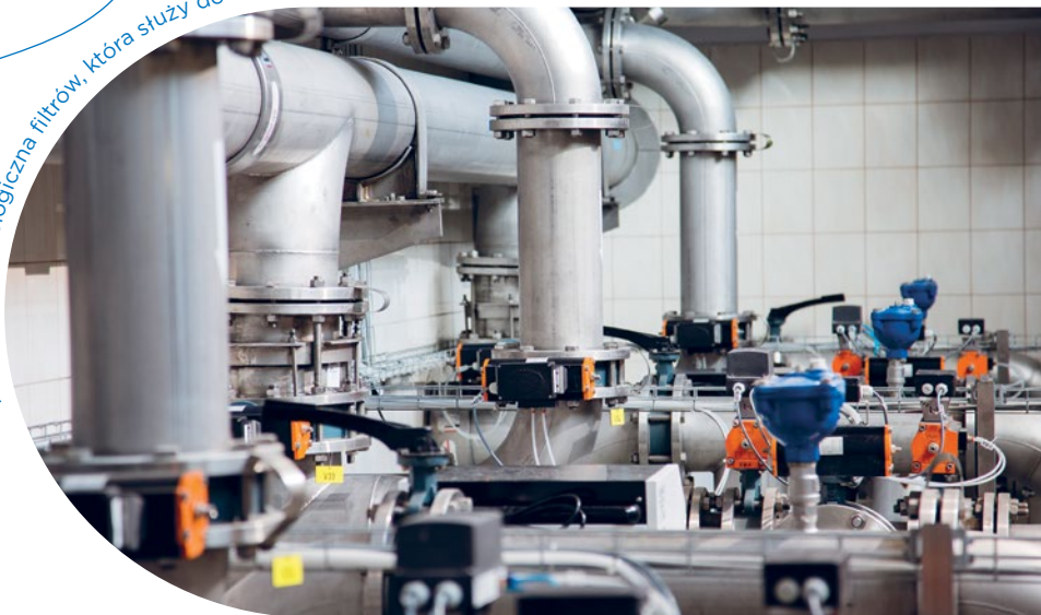
Wnętrze stacji uzdatniania wody ujęcia Pręgowo
