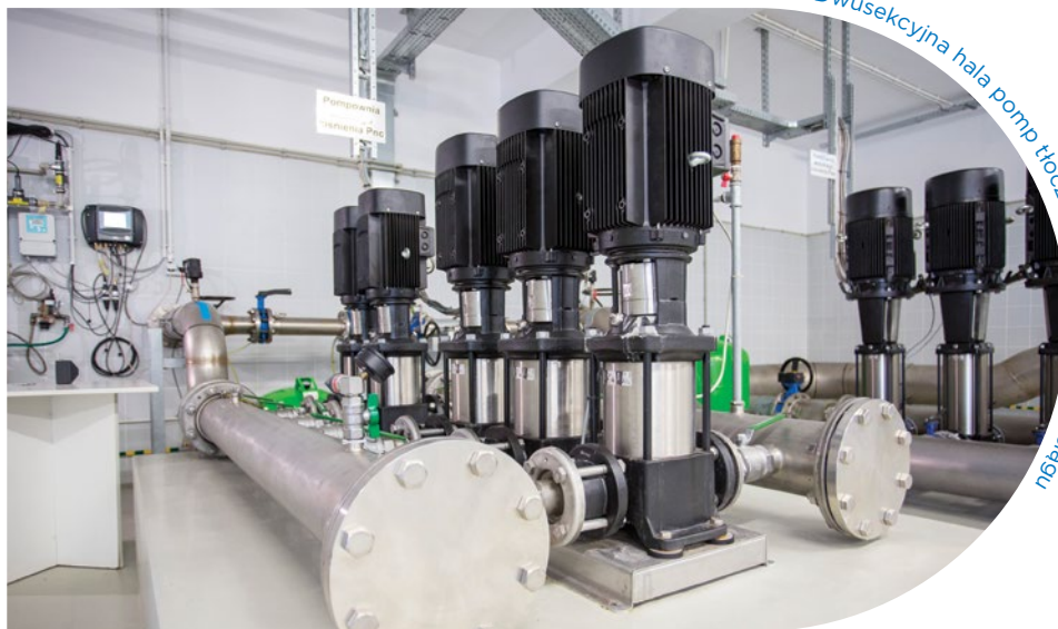
Wnętrze stacji uzdatniania wody ujęcia Zakoniczyn
